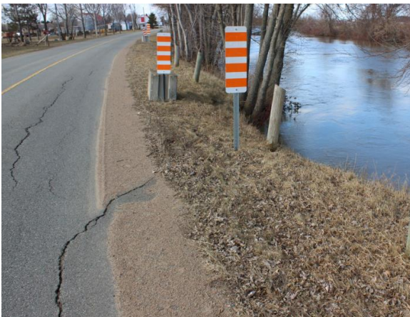
Figure 12 : Photo de parcelles de terrains en bordure de route susceptibles aux décrochages
